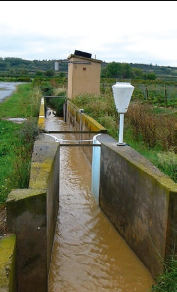
▲ Dispositif de mesure du débit, de la qualité de l'eau et de la pluie à l'exutoire du site
